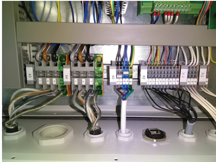
Abbildung 7: Klemmleiste im Steuerschrank der HydroStar Gegenstromanlage (hier von einer Doppelanlage, bei einer Anlage mit nur einer Turbine fehlen die Klemmen X4).
